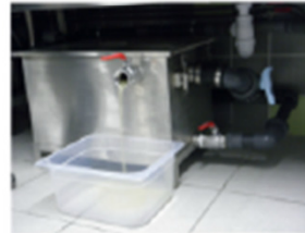
2 - fermer la vanne bleue ouvrir la vanne "graisses"
